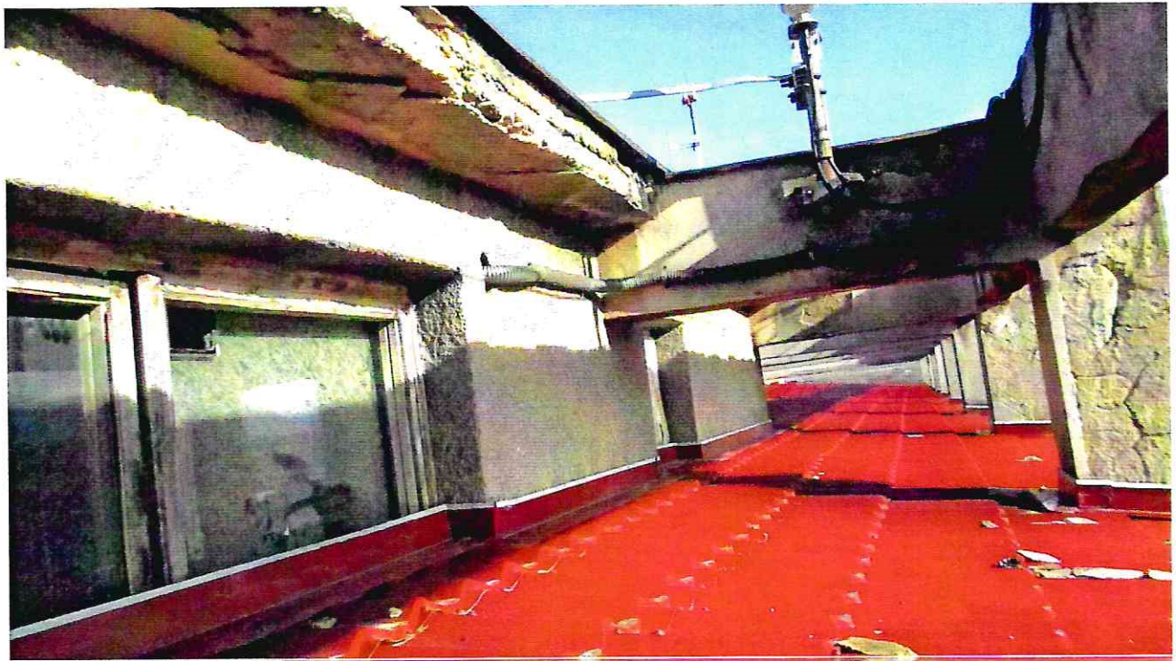
FOTO nr. 14 - Degradări elemente pergolă.
