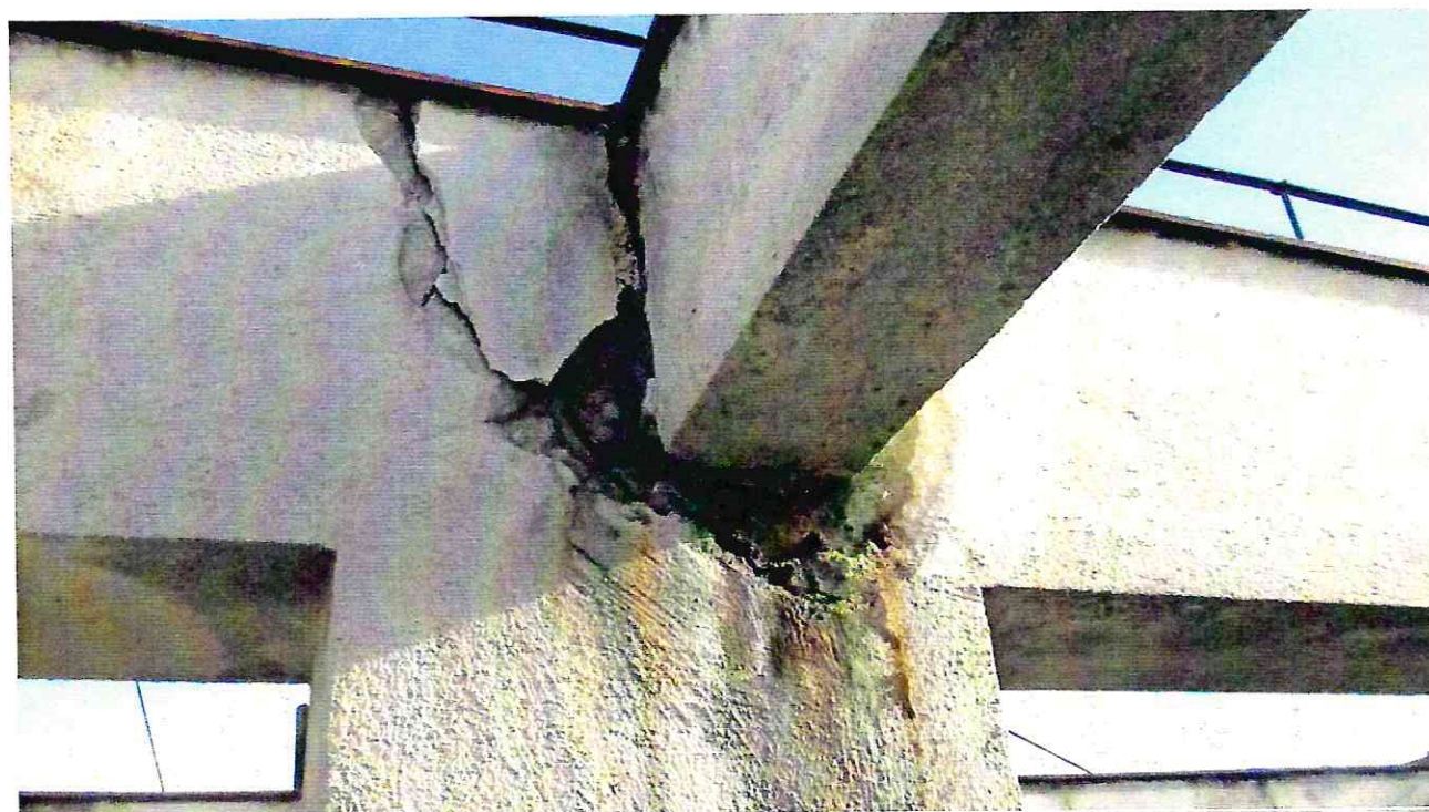
FOTO nr. 10 - Degradări la reazeme.
