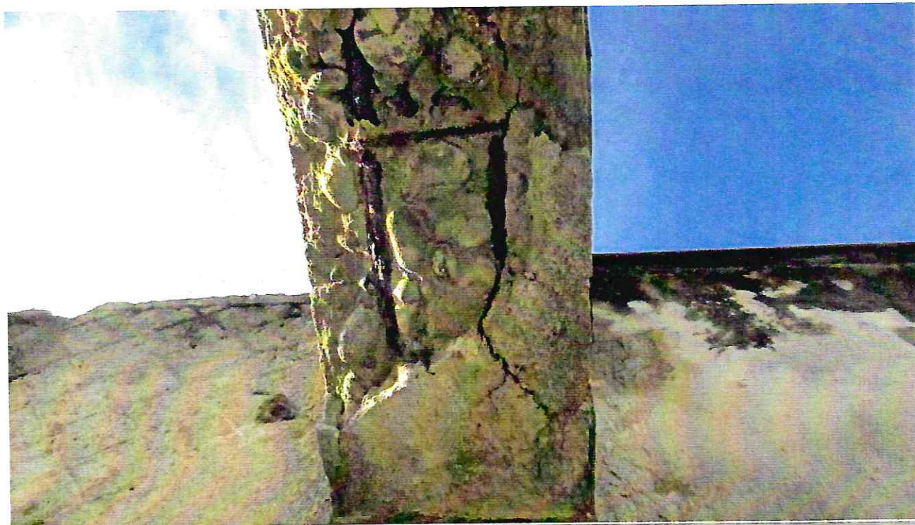
FOTO nr. 09 - Exfolieri beton.
