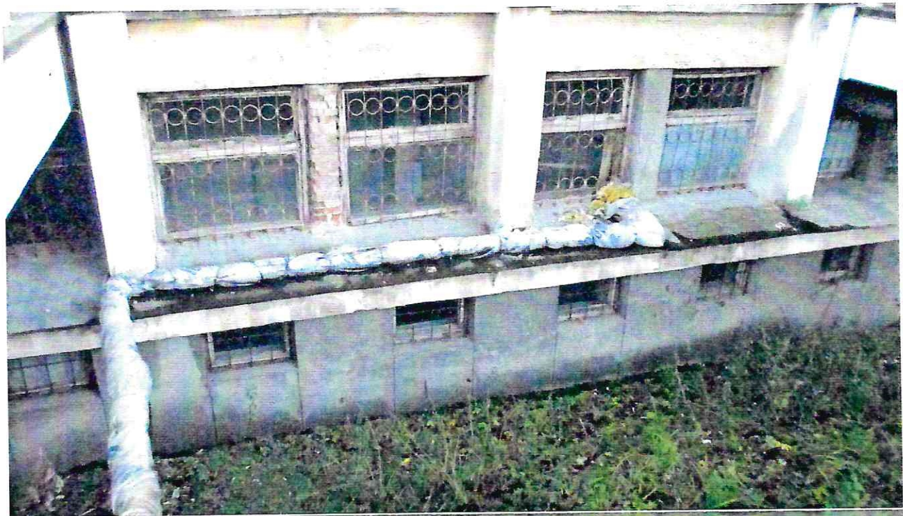
FOTO nr. 05 - Degradări fațadă SUD.
