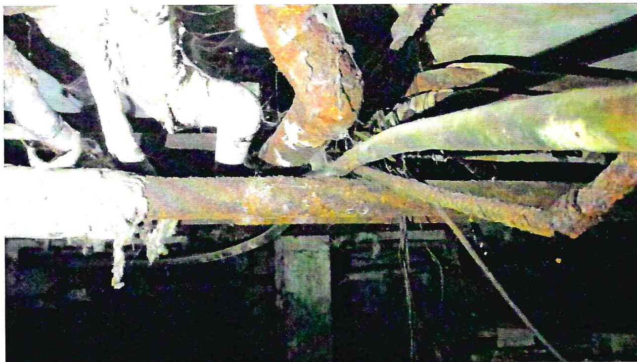
FOTO nr. 21 - Conducte instalatii subsol.
